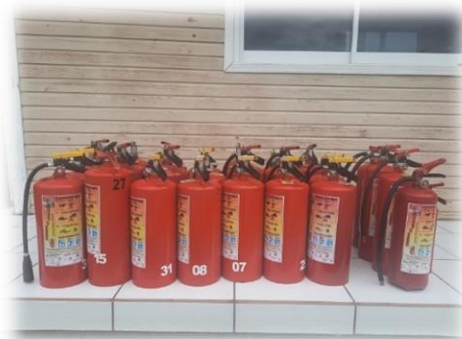
Protección Civil del ITES, recarga de extintores
